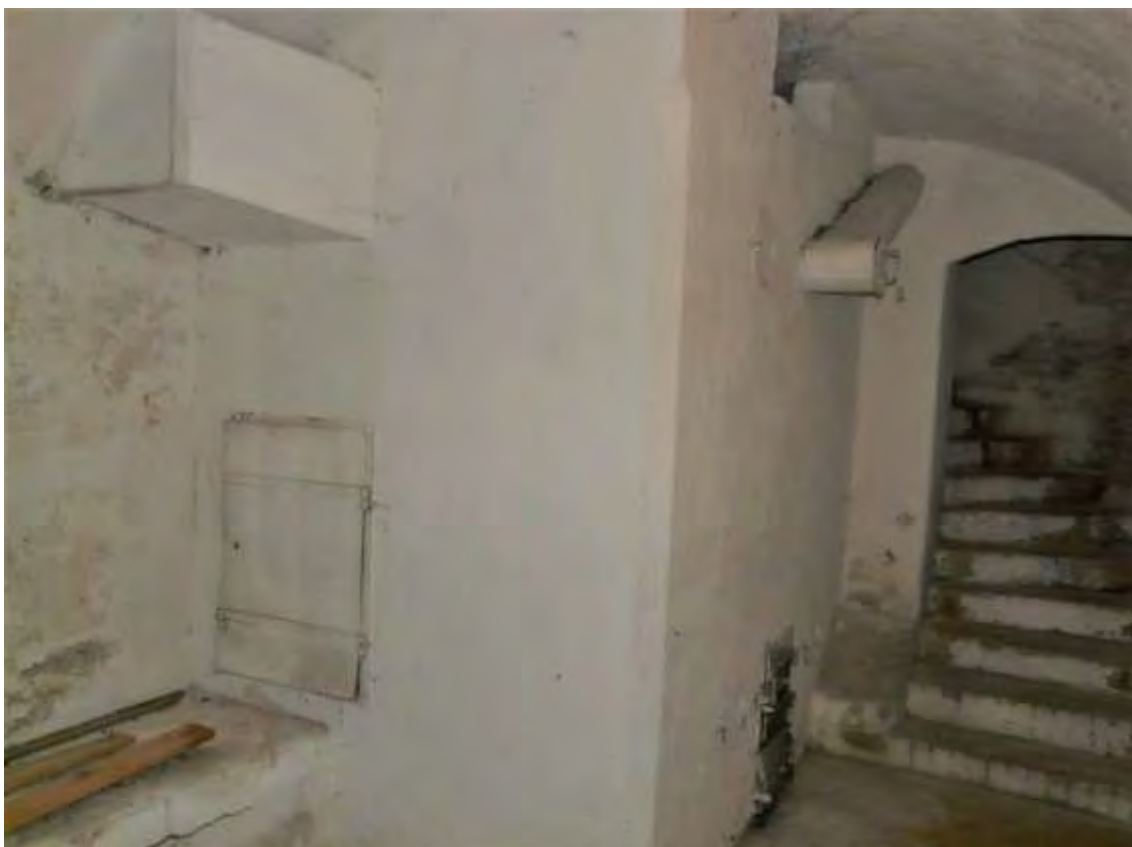
Der Heizraum für die Warmluftheizung im Keller. / 📷 Jiří Netík Topeniště teplovzdušného vytápění ve sklepě. / 📷 Jiří Netík
